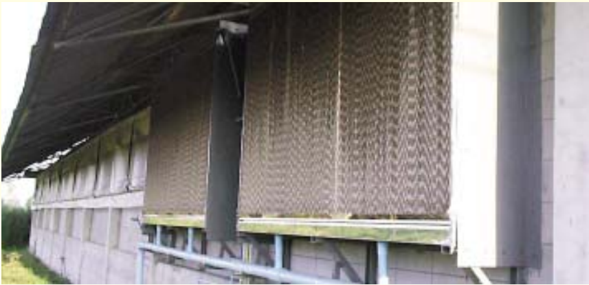
โรงเรือนระบบ Evaporative Cooling System
