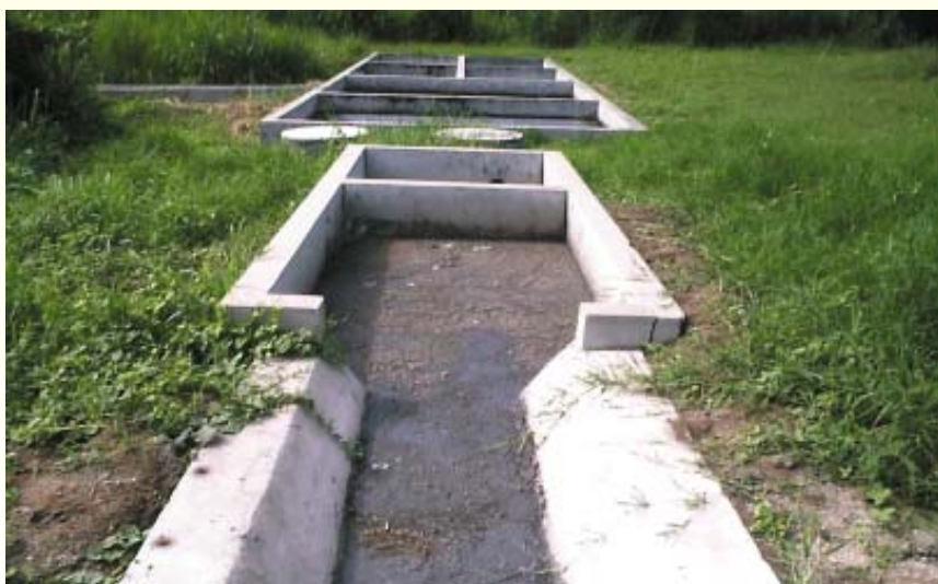
บ่อบำบัดน้ำเสีย
